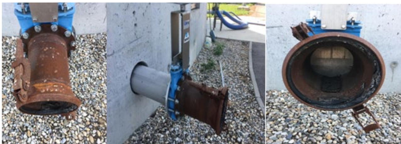
Slika 3. Cijevni priključak na izlaznoj cijevi za odvoz digestata [5]
