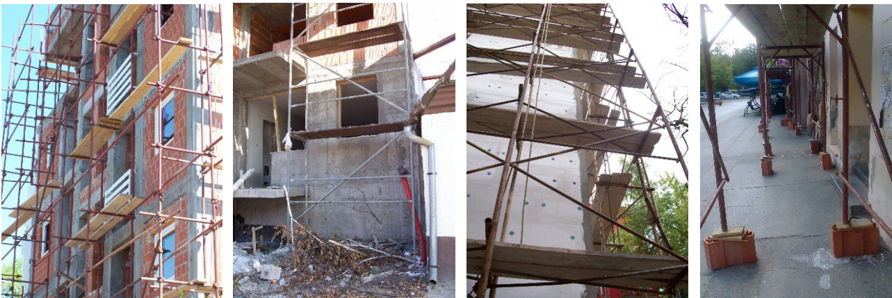
Slika 4. Skele koje nisu u skladu s propisanim pravilima za siguran rad
