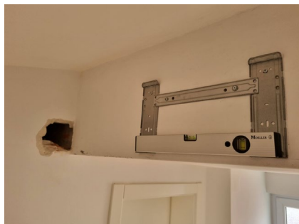
Slika 10. Smještaj unutarnje jedinica na betonskom nadvoju.
