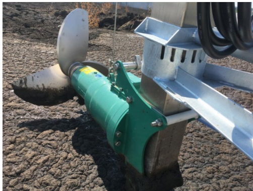
Slika 8. Korozija lopatica mješača digestata [5]
